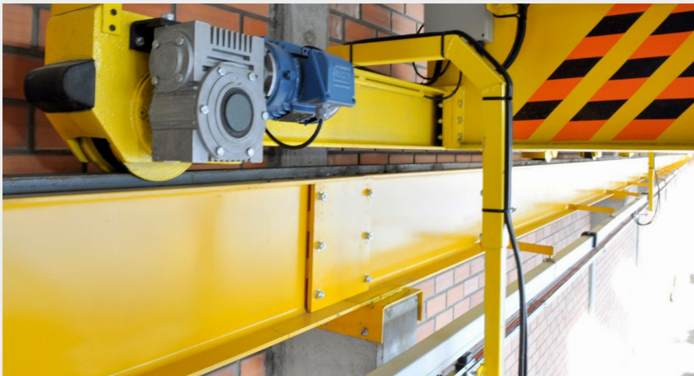
■ Ponte rolante apoiada sobre viga metálica.
